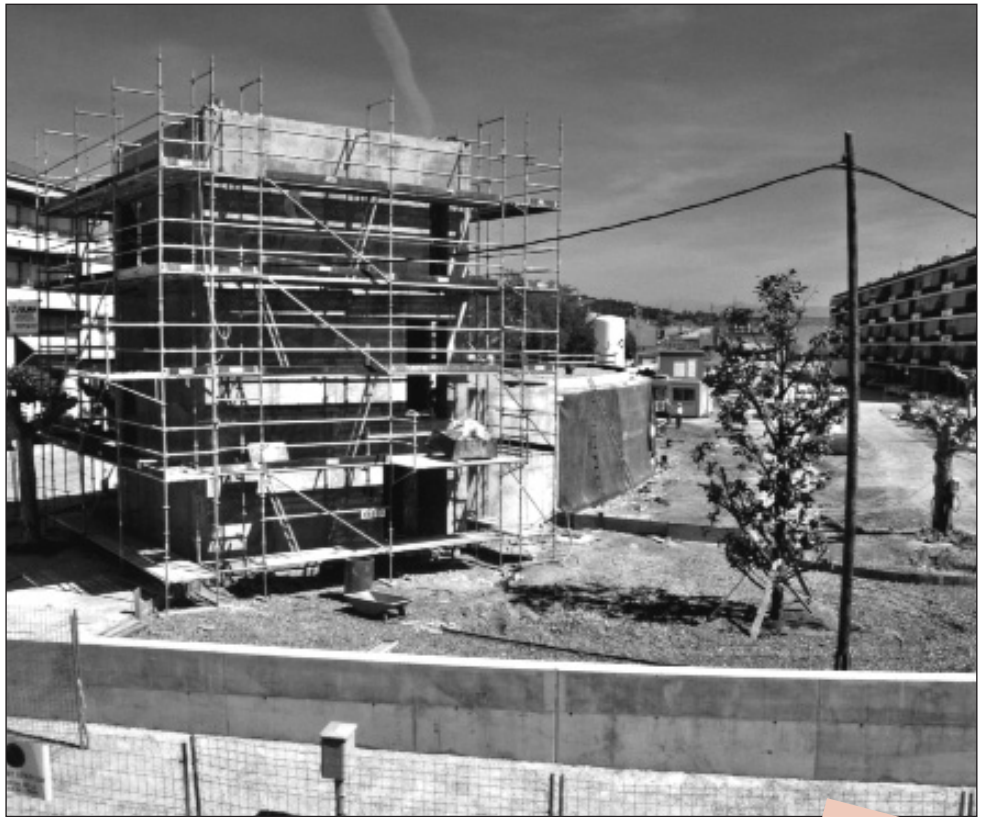
Les obres de construcció de la llar d'infants ja són en marxa
