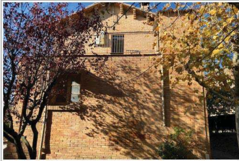
FAÇANA LATERAL EST. S'hi pot observar, a planta primera, la terrassa per on s'accedeix a l'habitatge (situat a planta primera)
